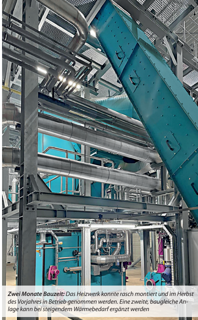
2 MW Leistung hat die Fernwärmanlage mit Poly-Held-Holzvergaseranlage von Polytechnik in Oberpullendorf. Damit ist sie das bislang größte Heizwerk dieses Typs des niederösterreichischen Biomassekesselbauers
